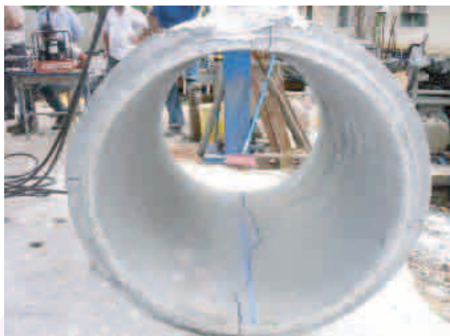
Falla de una tubería de concreto
