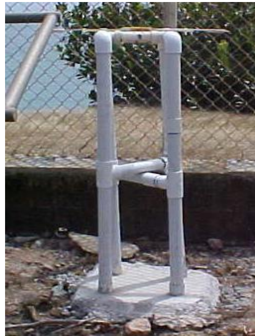
Fig. 7 Captador de Dióxido de Azufre, Estación Rompeolas
